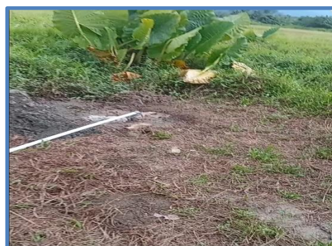
Gambar 2. Instalasi Irigasi Pipa Tetes
